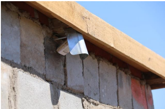
2 –р зураг. Хөдөлгөөн мэдрэгчийг байрлуулсан байдал
